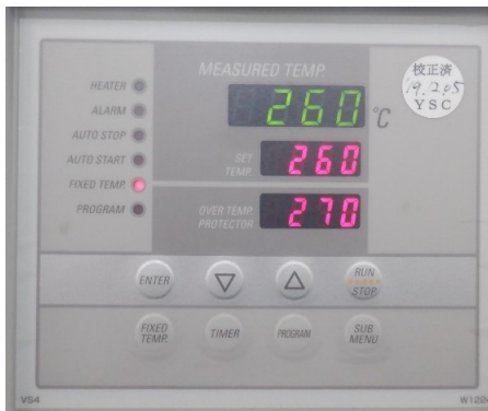
設定温度 260℃稼働 表示温度260℃
